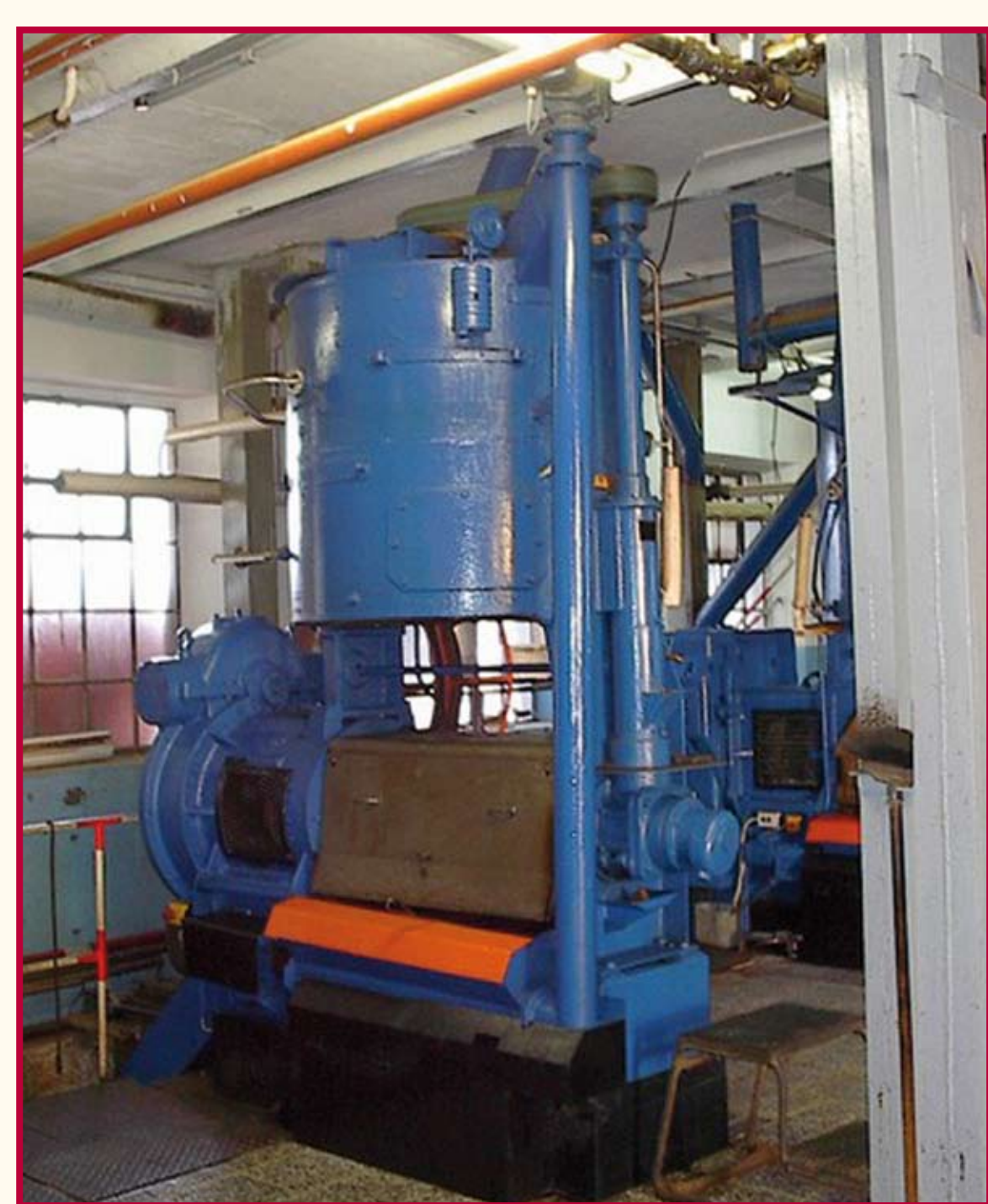
Das Herzstück der Lausitzer Ölmühle – der Pressenraum.
